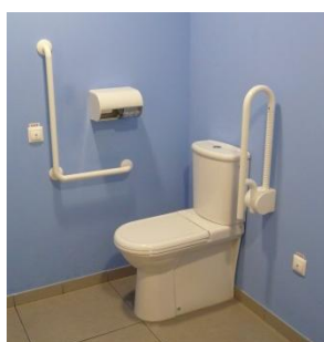
Inodoro con pulsador de emergencia.
