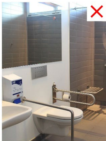
Inodoro suspendido largo. accesible No dispone de apoyo cómodo para la espalda.
