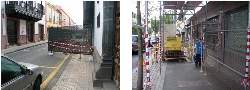
Obras que invaden el itinerario peatonal accesible
